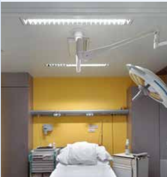
Arriba y derecho: Dodoens Hospital, Mechelen, Bélgica Arquitecto: Luyten & Lens Producto : Metal Chilled Linear 150C + 225C
